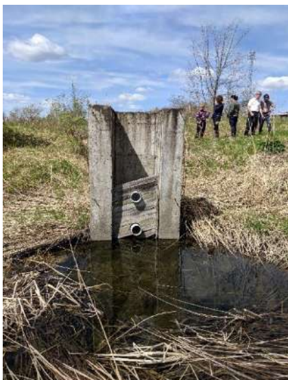
Figure 4 : Dispositif de sortie d'eau.
